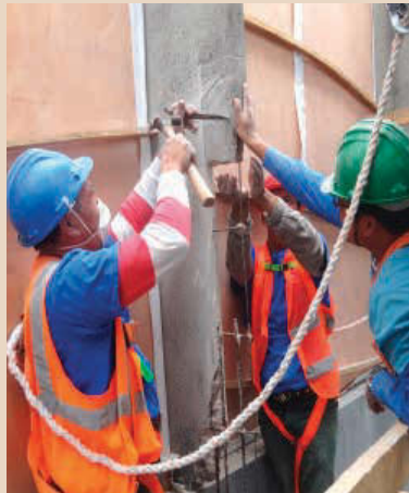
Delimitación del corte del daño
